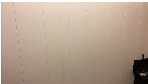
Enkelte hull i vegger.
