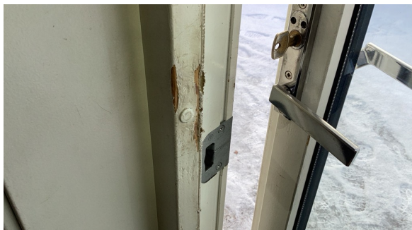
Skade på karm og tettelist.
