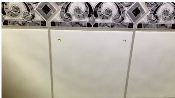
Hull i fliser etter tidligere installasjoner.
