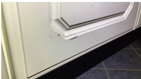
Svelling på innredning.
