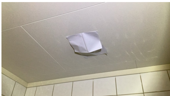
Avtrekksvifte er testet som beskrevet i NS3600.
