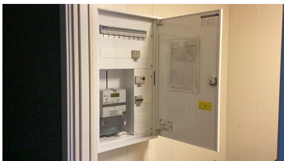
Sikringsskap på bod.
