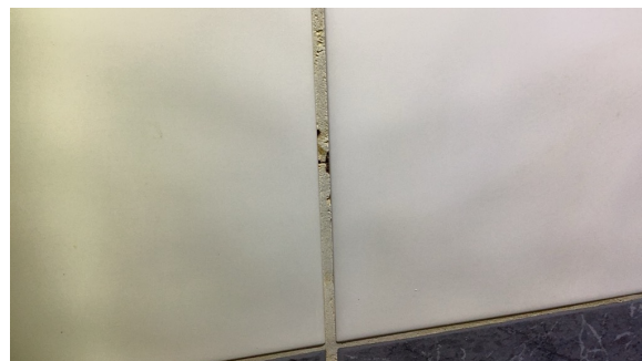
Riss i enkelte flisfuger.
