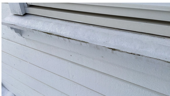
Behov for noe vedlikehold.
