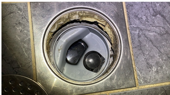
Løs pakning i sluk.
