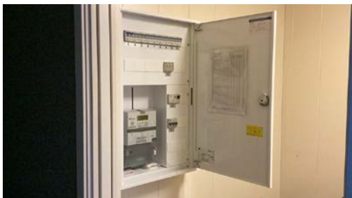
Sikringsskap på bod.
