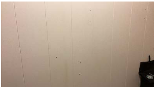
Enkelte hull i vegger.
