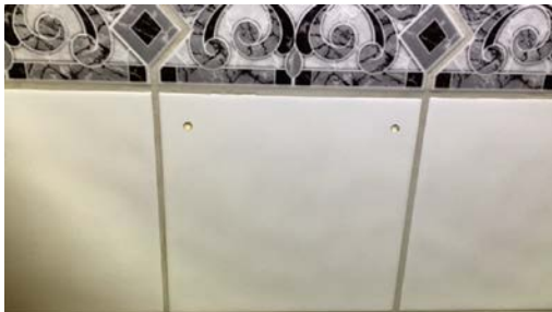
Hull i fliser etter tidligere installasjoner.
