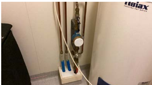
Stoppekran og vannmåler på bod.
