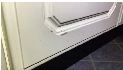
Svelling på innredning.
