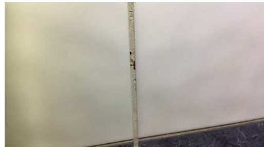
Riss i enkelte flisfuger.
