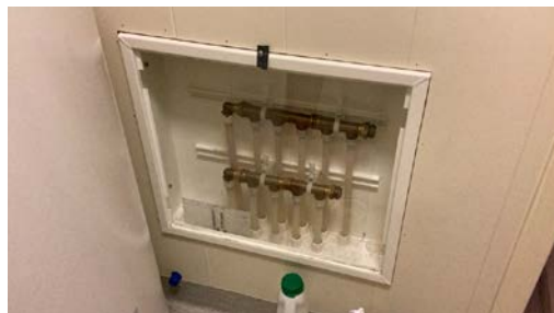
Fordelerskap på bod.
