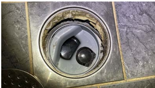
Løs pakning i sluk.
