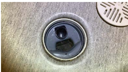
Sluk på bod.
