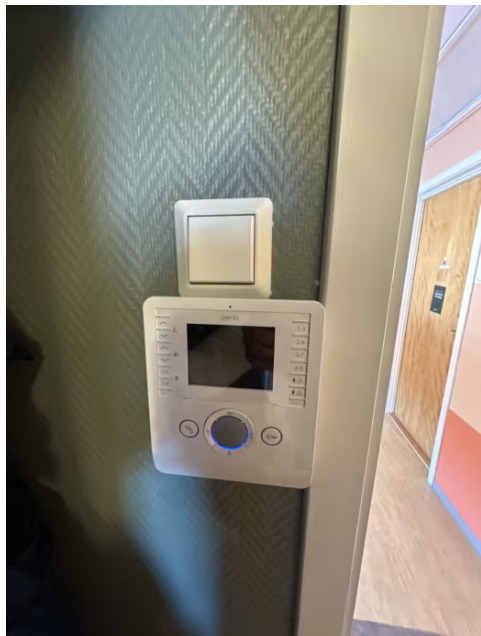
Viser porttelefon montert ved inngangsdør.
