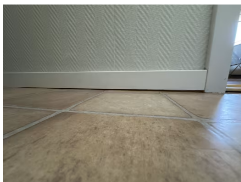
Det registreres glippe mellom gulv og list på kjøkkenet.
