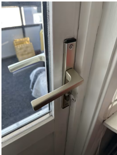
Terrassedør med vedlikeholdsbehov.
