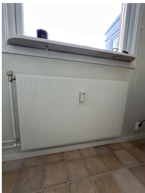
Viser radiator montert på kjøkkenet..
