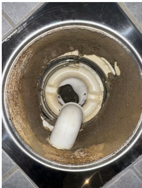
Viser sluk i dusjsonen. Avløp fra vaskemaskin og vask ført til sluk.
