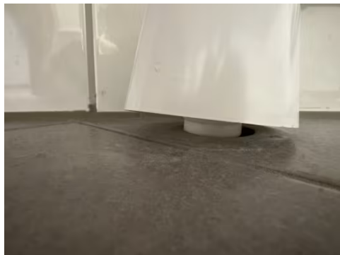
Rørføringer gjennom gulv for avløp til vask har ikke synlig membran / mansjetter over gulvet.
