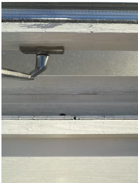
Tettelister bør byttes ved åpningsbare vinduer,
