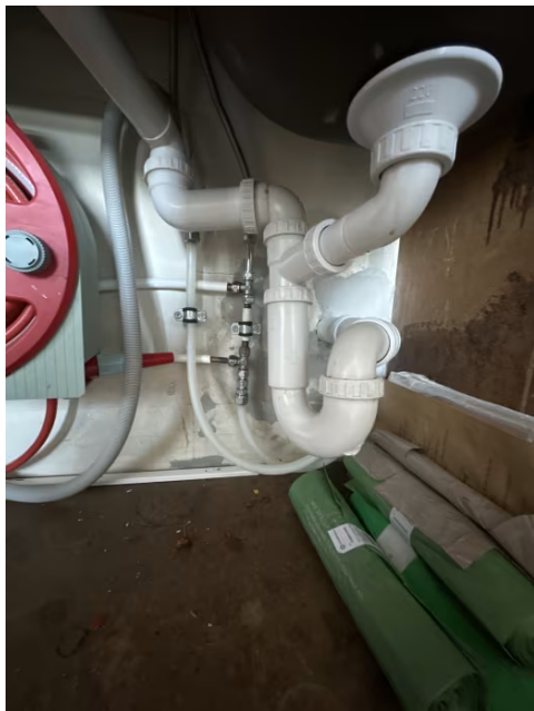
Viser vann og avløpsinnstallasjoner under kum.
