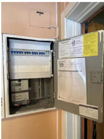
Viser sikringsskap plassert i gang.
