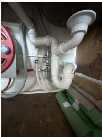
Viser vann og avløpsinnstallasjoner under kum.
