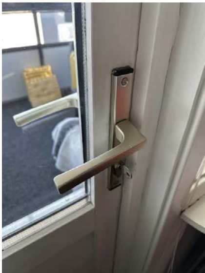
Terrassedør med vedlikeholdsbehov.
