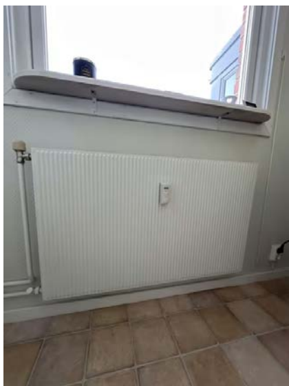
Viser radiator montert på kjøkkenet..
