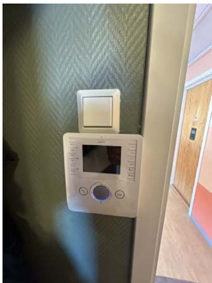
Viser porttelefon montert ved inngangsdør.
