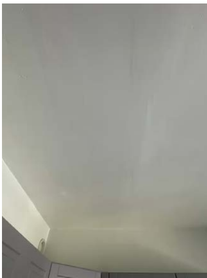
Det registreres stedvis skjolder i malte himlinger.
