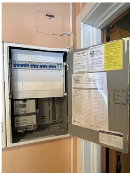
Viser sikringsskap plassert i gang.
