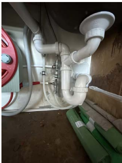
Viser vann og avløpsinnstallasjoner under kum.
