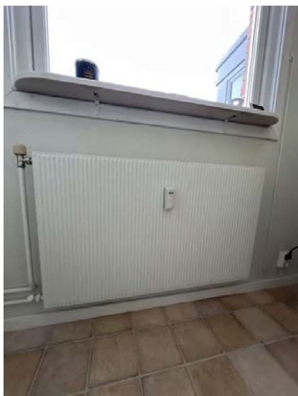
Viser radiator montert på kjøkkenet..
