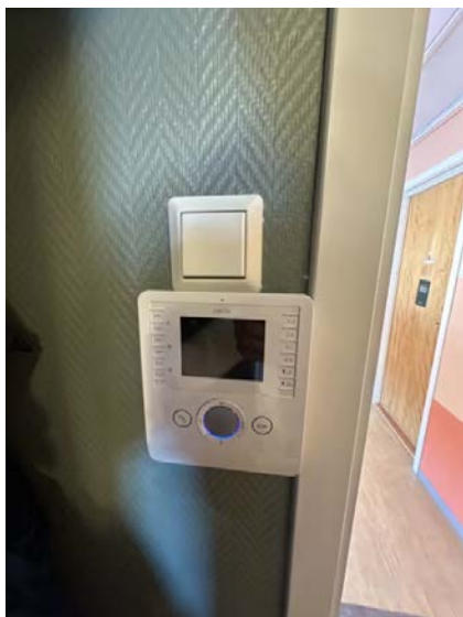
Viser porttelefon montert ved inngangsdør.
