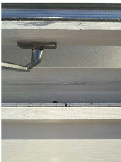
Tettelister bør byttes ved åpningsbare vinduer,
