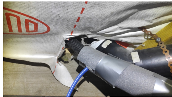
Deler av røret mangler isolasjon.
