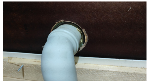
Manglende fugemasse rundt rør
