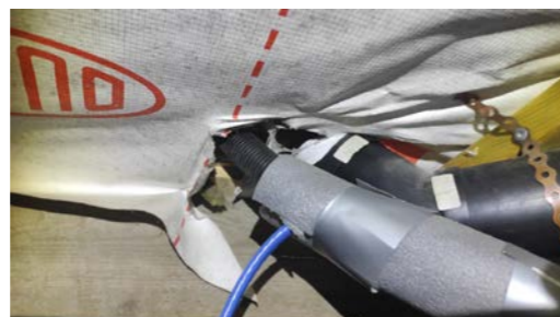
Deler av røret mangler isolasjon.
