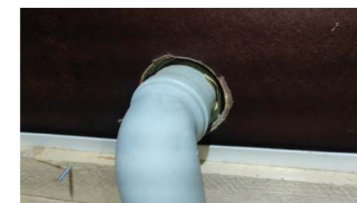
Manglende fugemasse rundt rør
