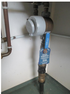
Innvendig stoppekran med vannmåler på vaskerommet.
