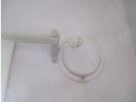
Ventil i ytterveggen.
