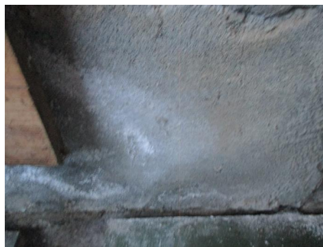
Noe salutslag og fuktvandring i nedre del av grunnmur i bod.
