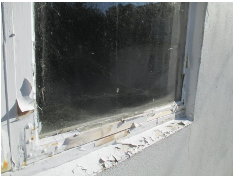
Trenger utvendig vedlikehold.
