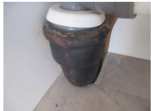
Søylrør ut av kjellergulvet.
