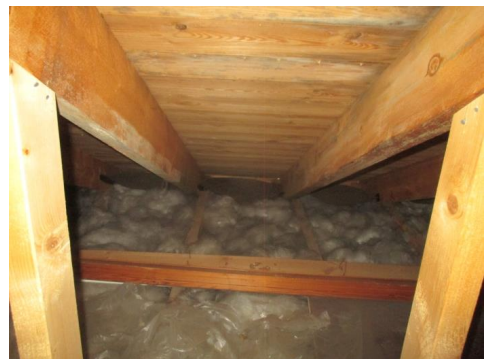
Lite tilgang på luft i fra takutstikk.
