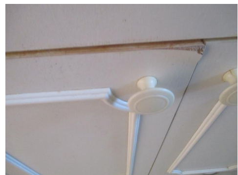
Skap dør har svellet noe.
