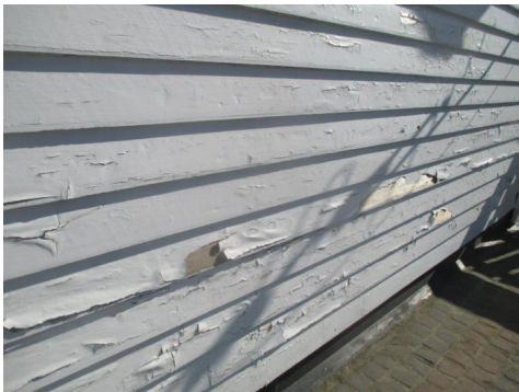
Maling løsner i fra underlaget.
