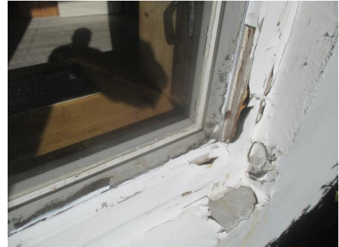
Slitte skadet vinduer i garasje.
