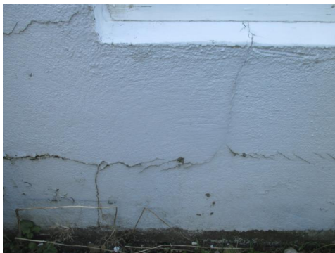
Noen mindre sprekker og riss i mellom blokker.
