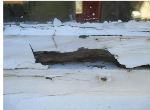
Råteskade på vindu til teknisk rom.
