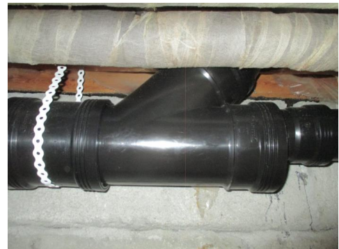
Plastrør i fra badet.
