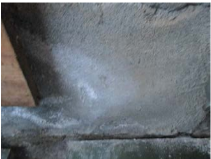
Noe salutslag og fuktvandring i nedre del av grunnmur i bod.
