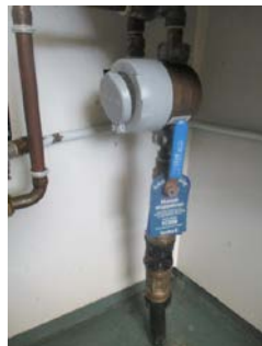
Innvendig stoppekran med vannmåler på vaskerommet.
