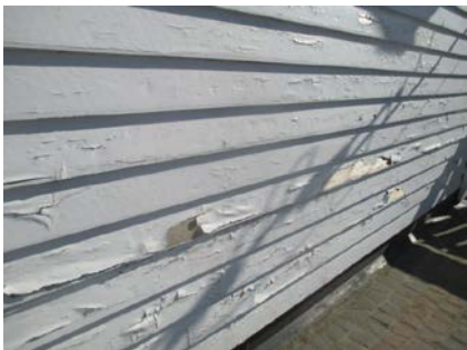
Maling løsner i fra underlaget.
