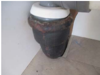
Søylrør ut av kjellergulvet.
