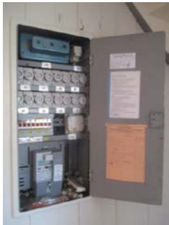
Sikringsskapet er plassert i hall.
