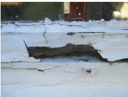
Råteskade på vindu til teknisk rom.
