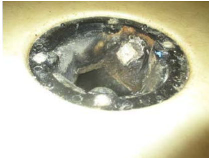
Sluk ved innredning.
