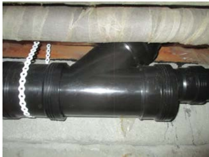
Plastrør i fra badet.
