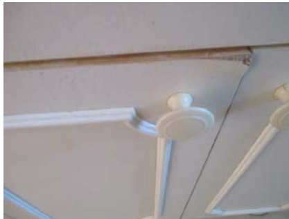
Skap dør har svellet noe.
