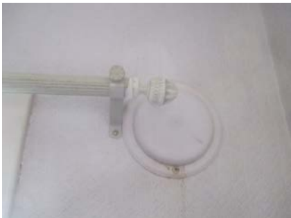
Ventil i ytterveggen.
