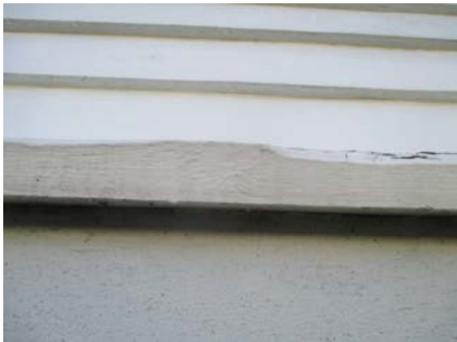
Ingen tilgang på luft bak kledningen ved grunnmur.
