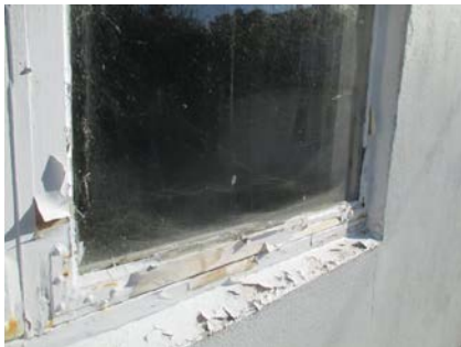
Trenger utvendig vedlikehold.
