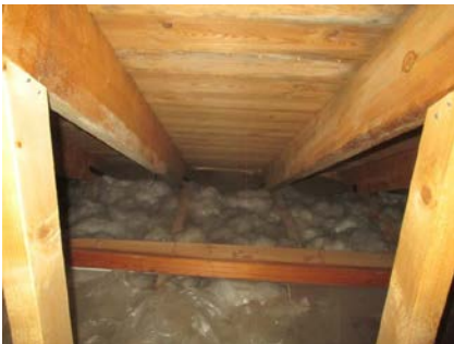
Lite tilgang på luft i fra takutstikk.
