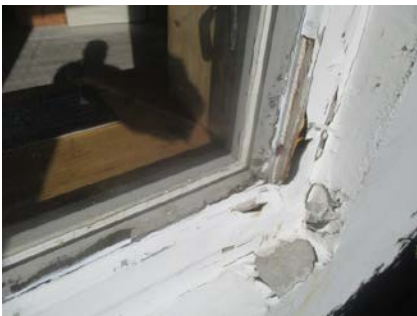
Slitte skadet vinduer i garasje.
