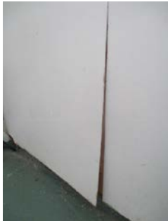
Tynne våtromsplater har løsnet.
