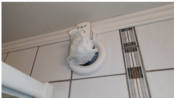
Test av avtrekket.
