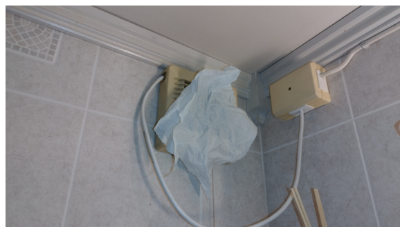
Test av avtrekket.
