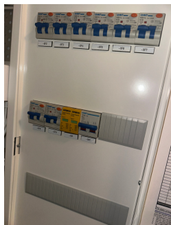
Sikringsskap med automatsikringer.
