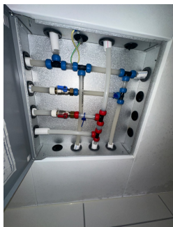
Samleskap med rørkurser og stoppekraner
