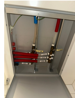
Samleskap med rørkurser og stoppekraner
