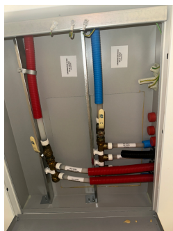
Samleskap med rørkurser og stoppekraner
