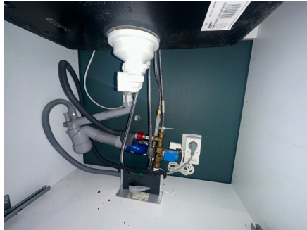
Røropplegg i kjøkkenbenk med Waterguard
