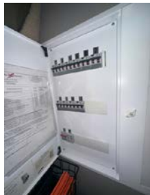
Sikringskap med automatsikringer.
