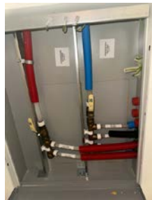
Samleskap med rørkurser og stoppekraner
