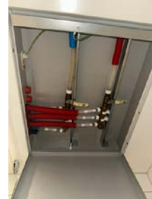
Samleskap med rørkurser og stoppekraner
