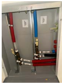
Samleskap med rørkurser og stoppekraner
