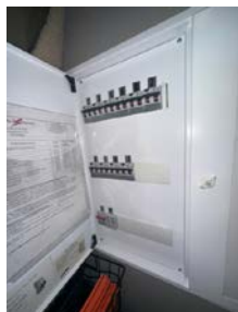
Sikringskap med automatsikringer.
