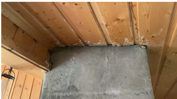
Fuktmerker rundt pipe i utvendig soverom. Merker var tørre ved befaring.
