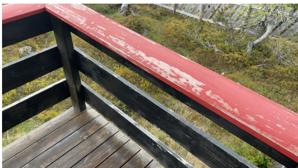
Slitasje på håndløper.
