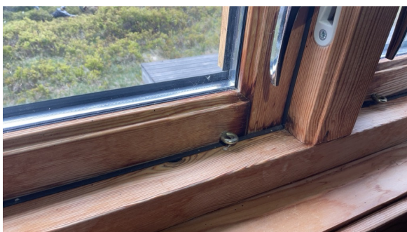
Kondensmerker/fuktmerker på enkelte vinduer.
