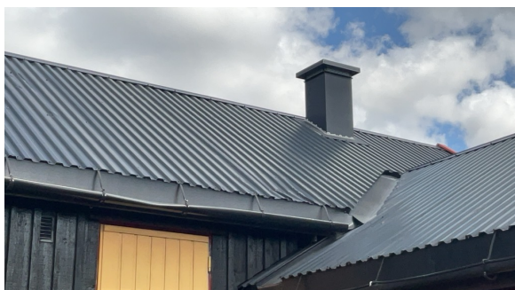
Bulker på taktekking enkelte steder.
