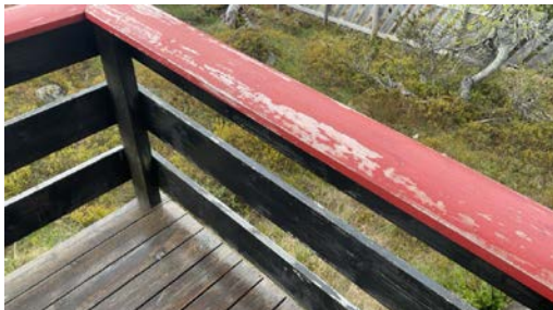
Slitasje på håndløper.
