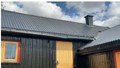
Takrenne har blitt bøyd, sannsynligvis som følge av snøras.
