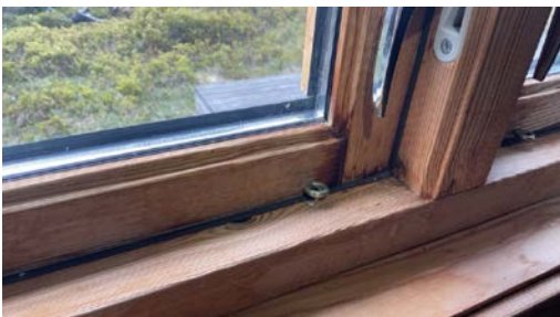
Kondensmerker/fuktmerker på enkelte vinduer.
