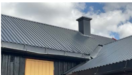
Bulker på takteking enkelte steder.
