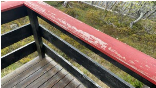
Slitasje på håndløper.
