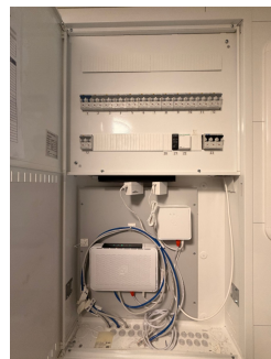
Bilde av sikringsskap hovedleilighet
