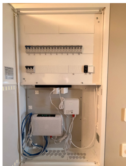
Bilde av sikringsskap utleieleilighet
