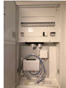
Bilde av sikringsskap hovedleilighet
