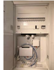
Bilde av sikringsskap hovedleilighet
