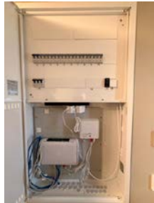
Bilde av sikringsskap utleieleilighet
