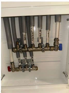
Samleskap med rørkurser og stoppekraner
