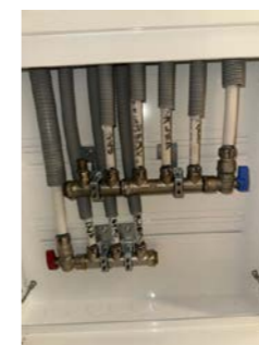
Samleskap med rørkurser og stoppekraner
