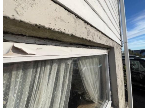
Råteskade i vinduer.
