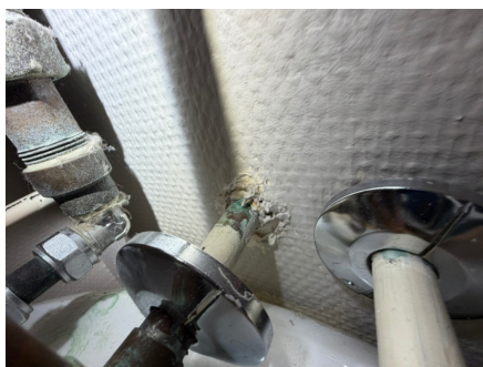
Eksempel på utett rørgjennomføring.
