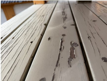
EKsempel på værslitt overflatebehandling.
