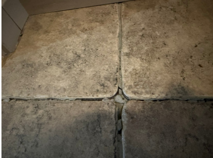
Eksempel på fuger som mangler.
