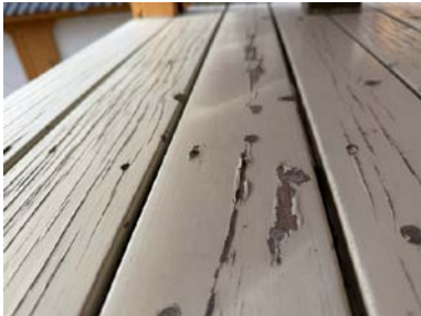
Eksempel på værslitt overflatebehandling.
