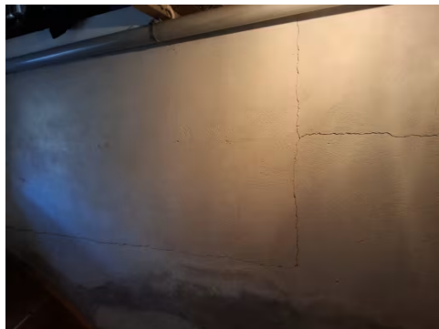
Riss/sprekker i grunnmuren.
