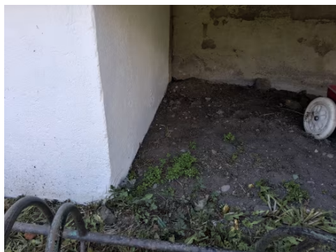
Deler av grunnmuren mangler fuktsperre.
