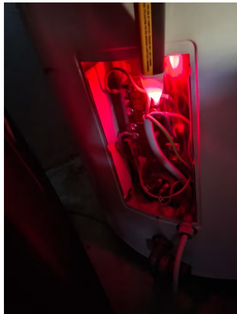
Det er berøringsfare på varmtvannsbereder i kjeller.
