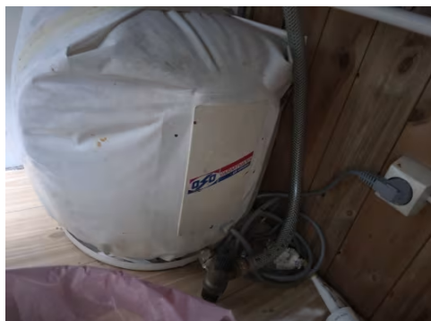
Varmtvannsbereder plassert i kjøkkeninnredning i loftsetasje.
