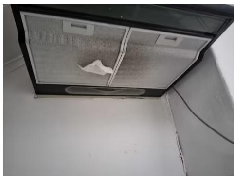
Avtrekkseffekten er testet med papir.
