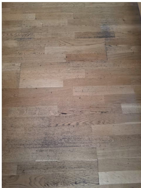
Kjøkkengulv bærer preg av slitasje.
