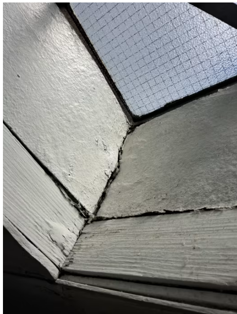
Det registreres eldre fuktskader rundt takvindu.
