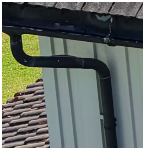
Det registreres buling på nedløpsrør.
