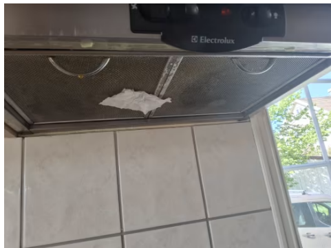
Avtrekkseffekten er testet med papir.
