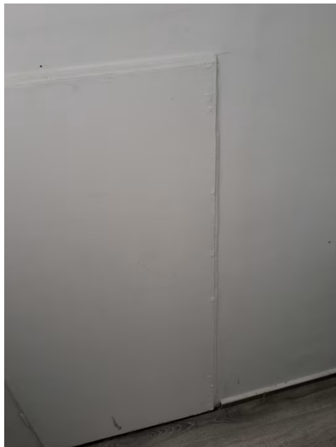
Luke til kott er gjenlimt med sparkel/maling.
