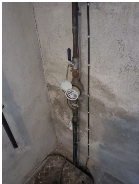
Hovedstoppekran er plassert i kjeller.
