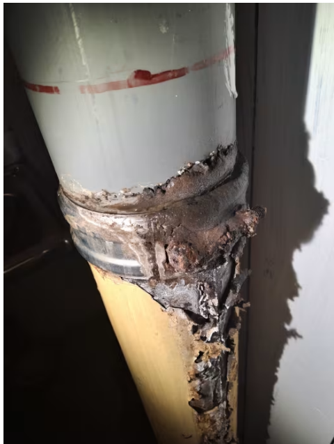
Tegn til lekkasje på avløpsrør i toalettrom.
