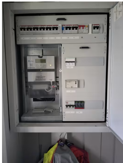
Sikringsskap plassert i gang.
