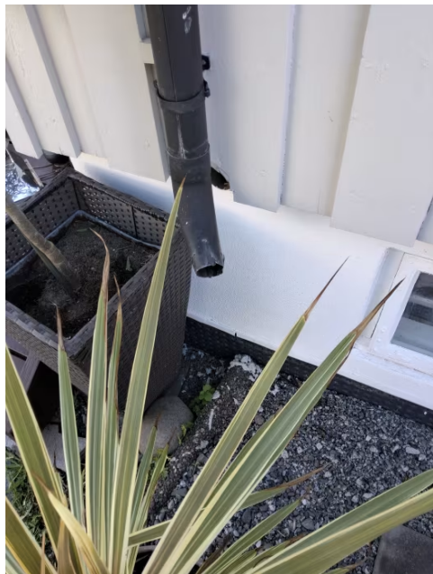
Taknedløp er avsluttet over terreng.
