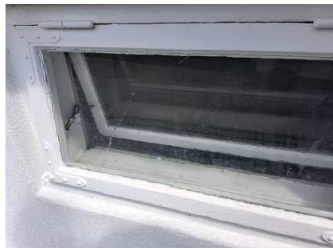
Sprekk i glass i kjellervindu.
