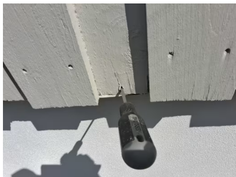
Stedvise råteskader i kledningen.
