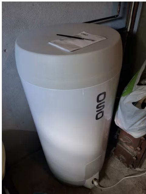
Varmtvannsbereder plassert i vaskekjeller.
