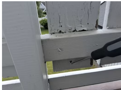
Påbegynt råteskade i rekkverksbord.
