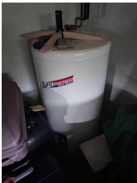
Varmtvannsbereder plassert i kjellerrom.
