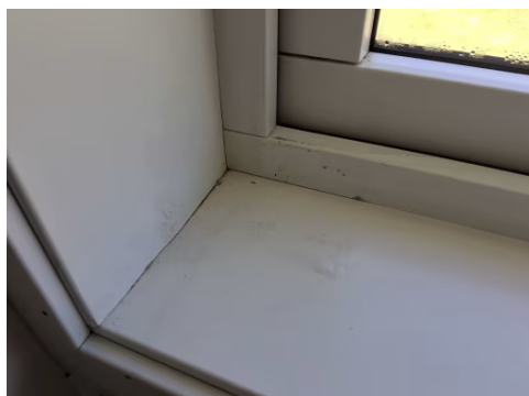
Svelleskader i utforing.
