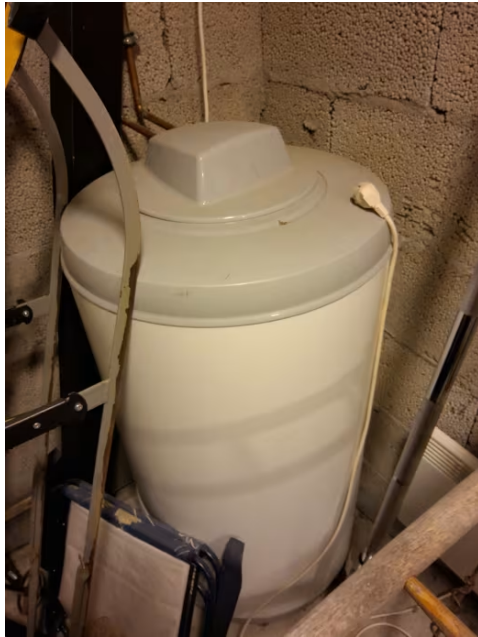
Varmtvannsbereder er plassert i bod.
