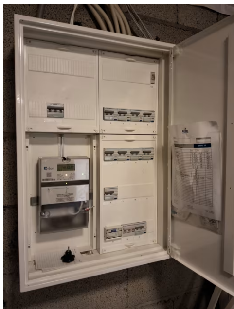
Sikringsskap i bod.
