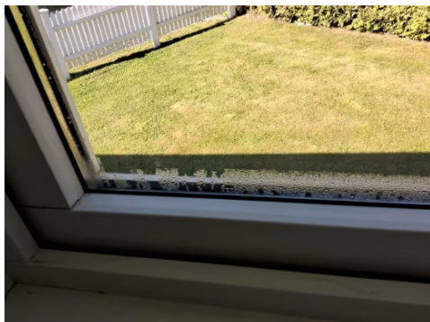
Det registreres kondens på soveromsvindu.
