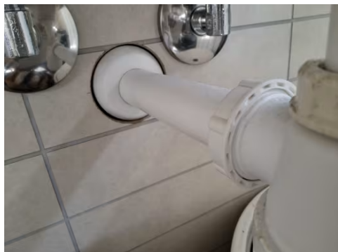
Utetthet rundt gjennomføring under servant.
