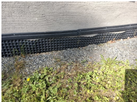
Grunnmursplast har løsnet fra topplist.
