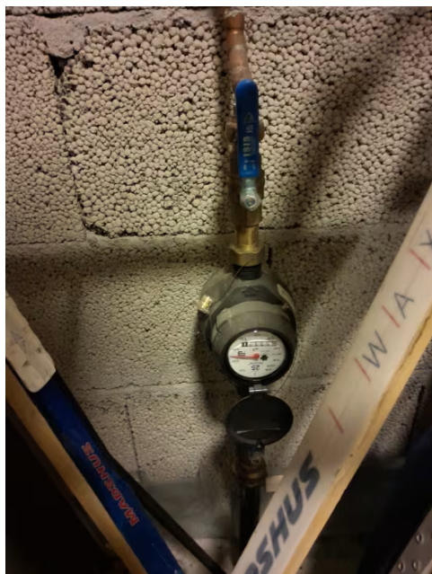
Hovedstoppekran er plassert i bod i kjeller.
