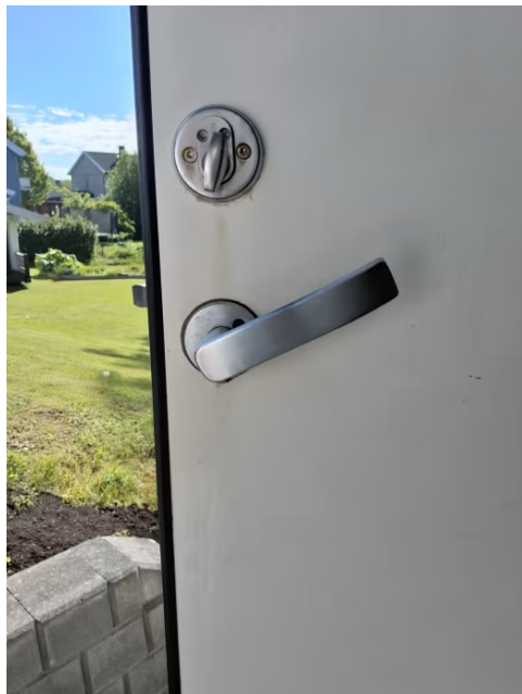
Defekt dørvrider til entrédør.
