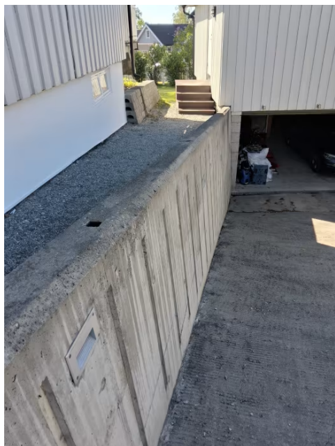
Det er ikke etablert rekkeverk på støttemurer.
