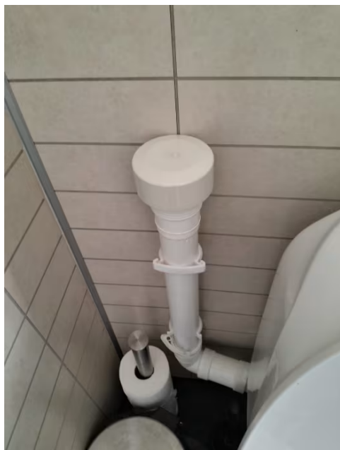
Vakuumventil er plassert på bad.
