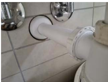
Utetthet rundt gjennomføring under servant.
