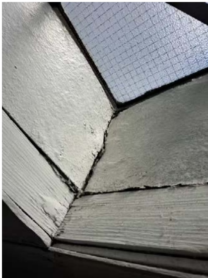
Det registreres eldre fuktskader rundt takvindu.
