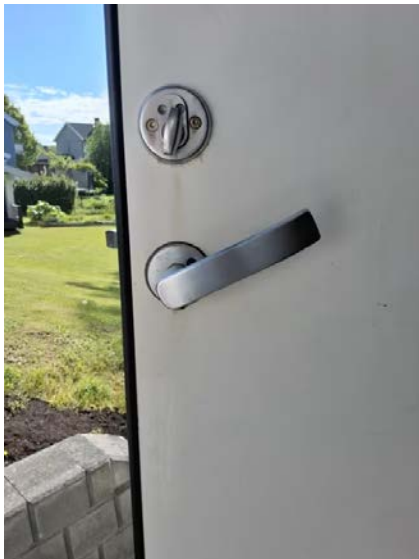
Defekt dørrider til entrédør.
