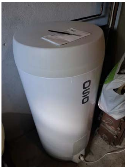
Varmtvannsbereder plassert i vaskekjeller.
