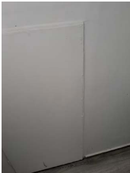
Luke til kott er gjenlimt med sparkel/maling.
