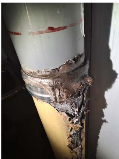
Tegn til lekkasje på avløpsrør i toalettrom.
