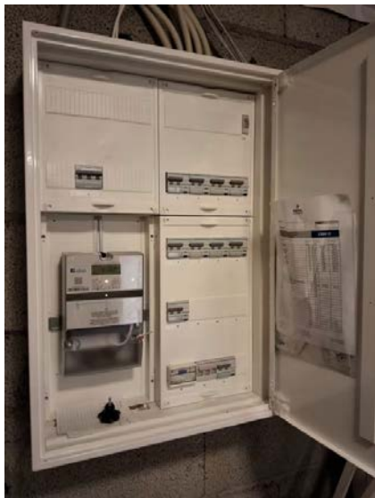
Sikringsskap i bod.
