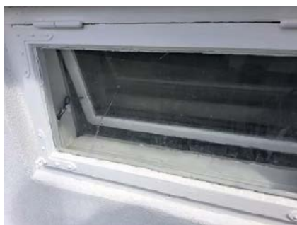
Sprekk i glass i kjellervindu.
