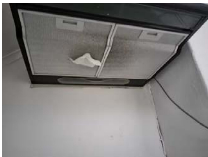
Avtrekkseffekten er testet med papir.
