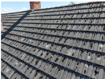
Det registreres mosevekster og værslitt takteking.
