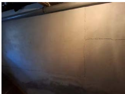
Riss/sprekker i grunnmuren.
