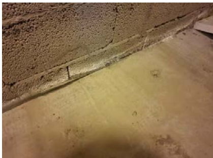
Det registreres salg/kalkutslag på grunnmur.
