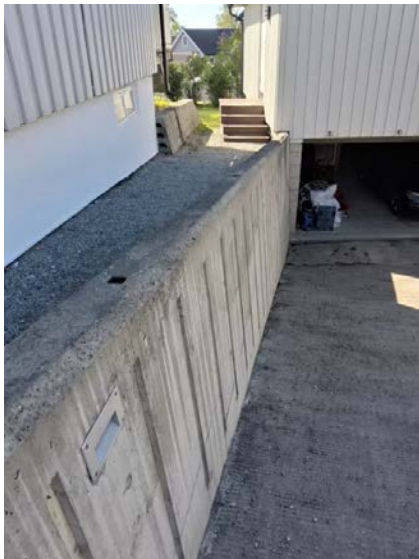
Det er ikke etablert rekkeverk på støttemur.
