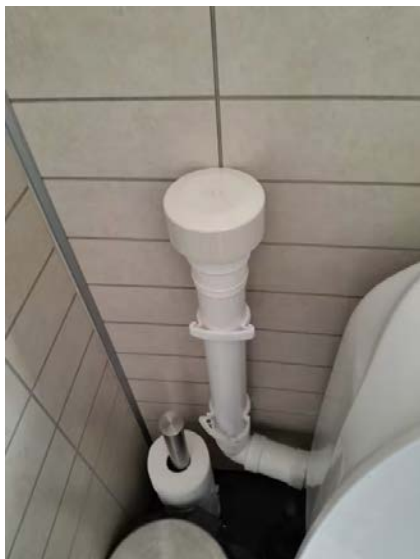
Vakuumventil er plassert på bad.
