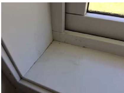
Svelleskader i utforing.
