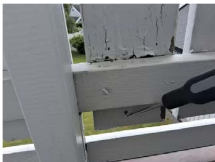
Påbegynt råteskade i rekkverksbord.
