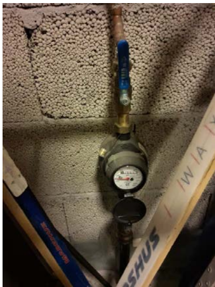
Hovedstoppekran er plassert i bod i kjeller.
