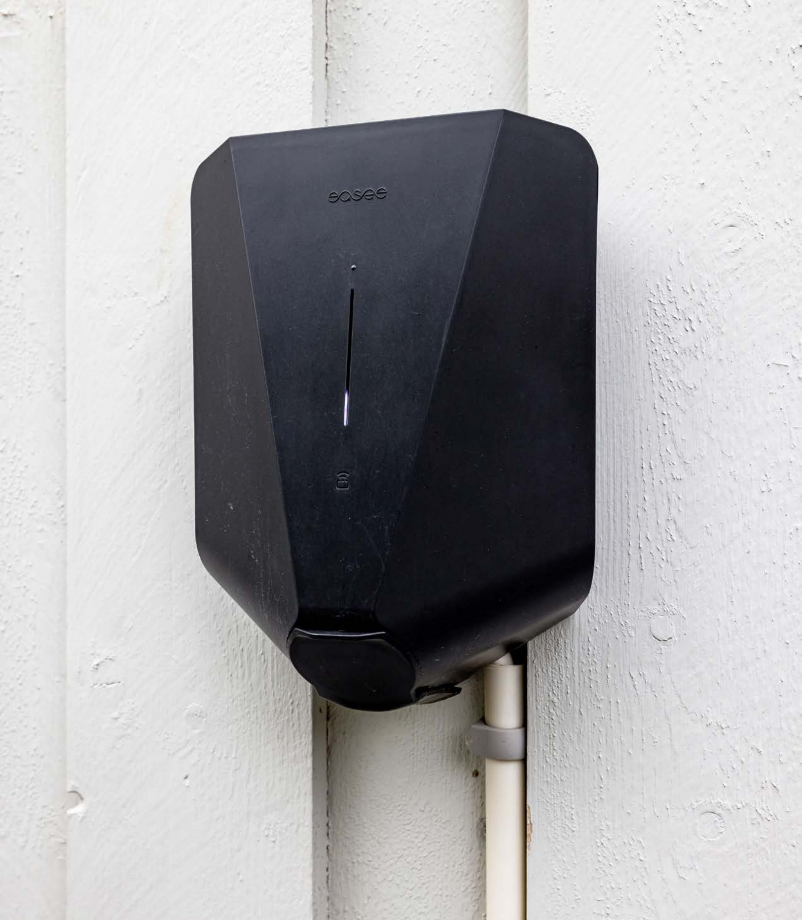
Det er montert elbil-lader på husveggen.
