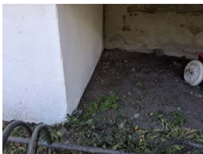
Deler av grunnmuren mangler fuktsperre.
