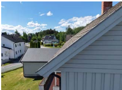
Det registreres mindre svanker i takflaten.
