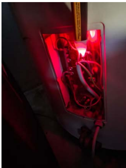
Det er berøringsfare på varmtvannsbereder i kjeller.
