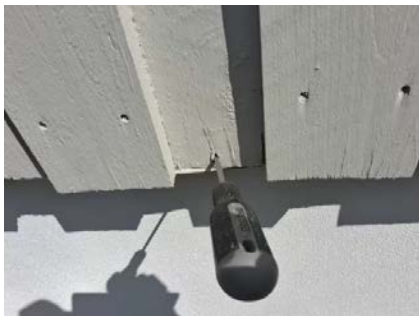
Stedvise råteskader i kledningen.
