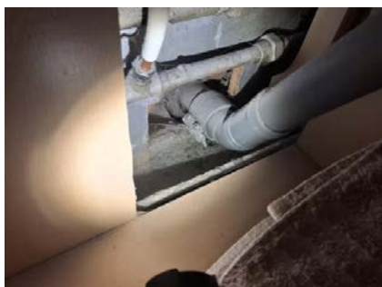
Åpninger i vegg bak servant.
