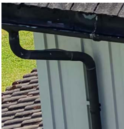
Det registreres buling på nedløpsrør.
