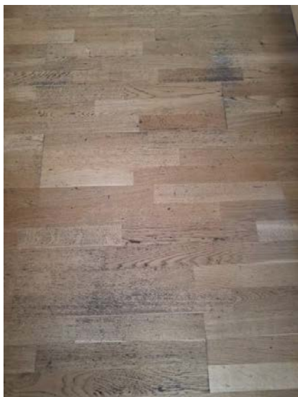
Kjøkkengulv bærer preg av slitasje.
