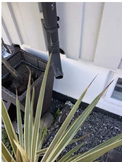
Taknedløp er avsluttet over terreng.
