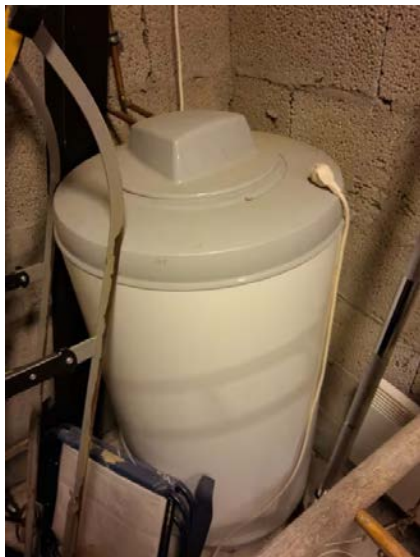
Varmtvannsbereder er plassert i bod.
