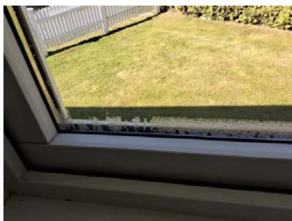
Det registreres kondens på soveromsvindu.
