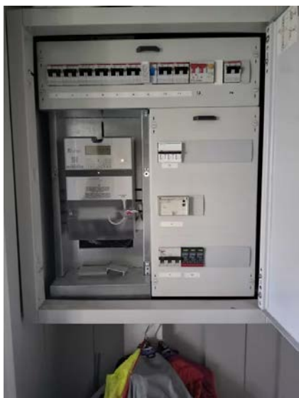
Sikringsskap plassert i gang.
