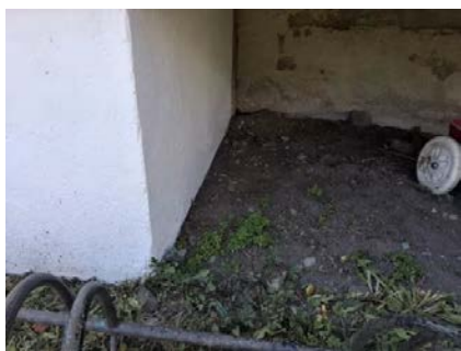
Deler av grunnmuren mangler fuktsperre.
