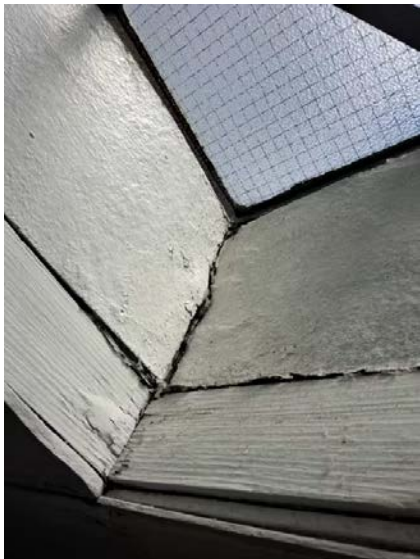
Det registreres eldre fuktskader rundt takvindu.
