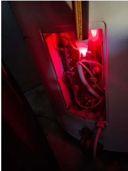
Det er berøringsfare på varmtvannsbereder i kjeller.
