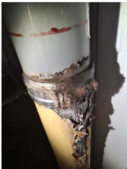
Tegn til lekkasje på avløpsrør i toalettrom.
