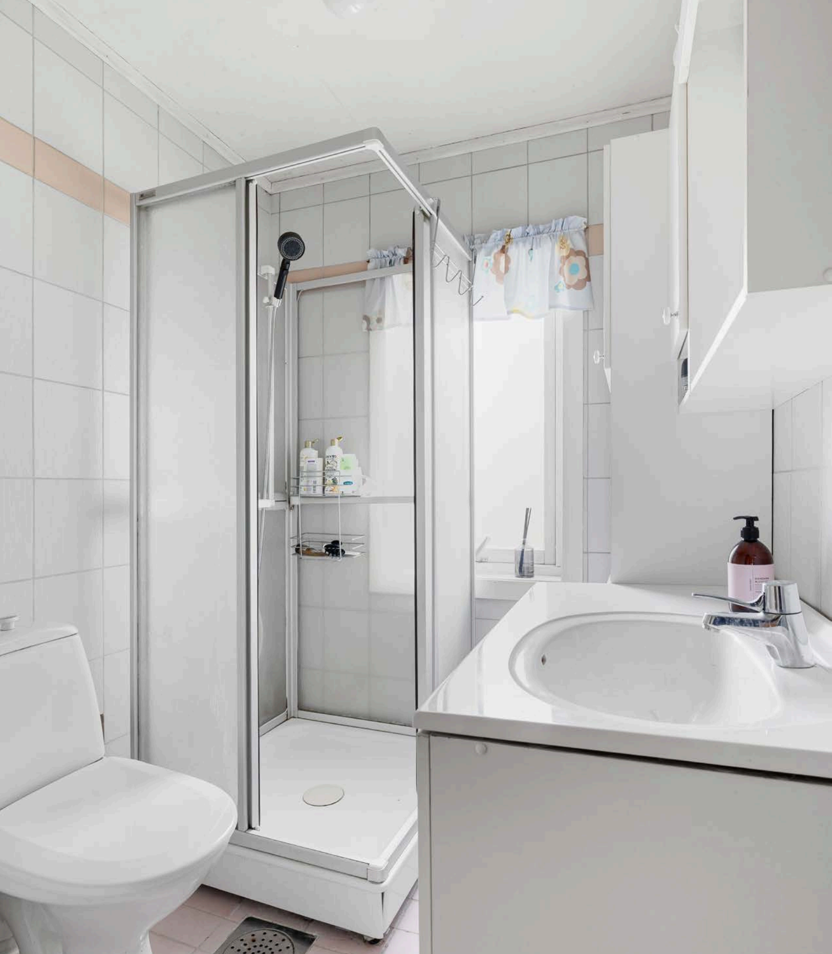
Baderommet til hybelleiligheten ligger i boligens 2. etasje. Lyst flislagt baderom som er utstyrt med servanttinnredning, dusjkabinett og gulvstående toalett. Baderommet har fått TG3 og har behov for totalreovering.
