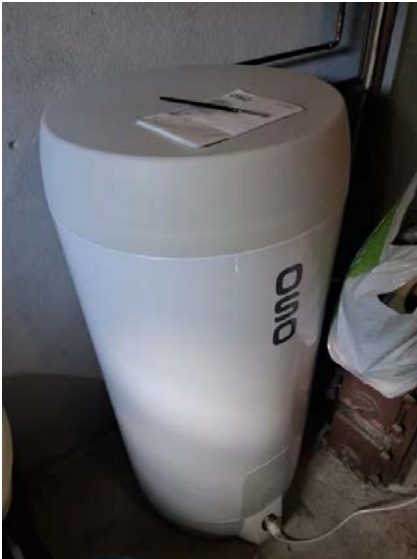
Varmtvannsbereder plassert i vaskekjeller.
