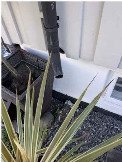
Taknedløp er avsluttet over terreng.
