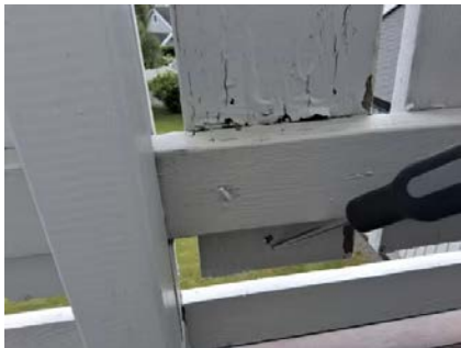
Påbegynt råteskade i rekkverksbord.
