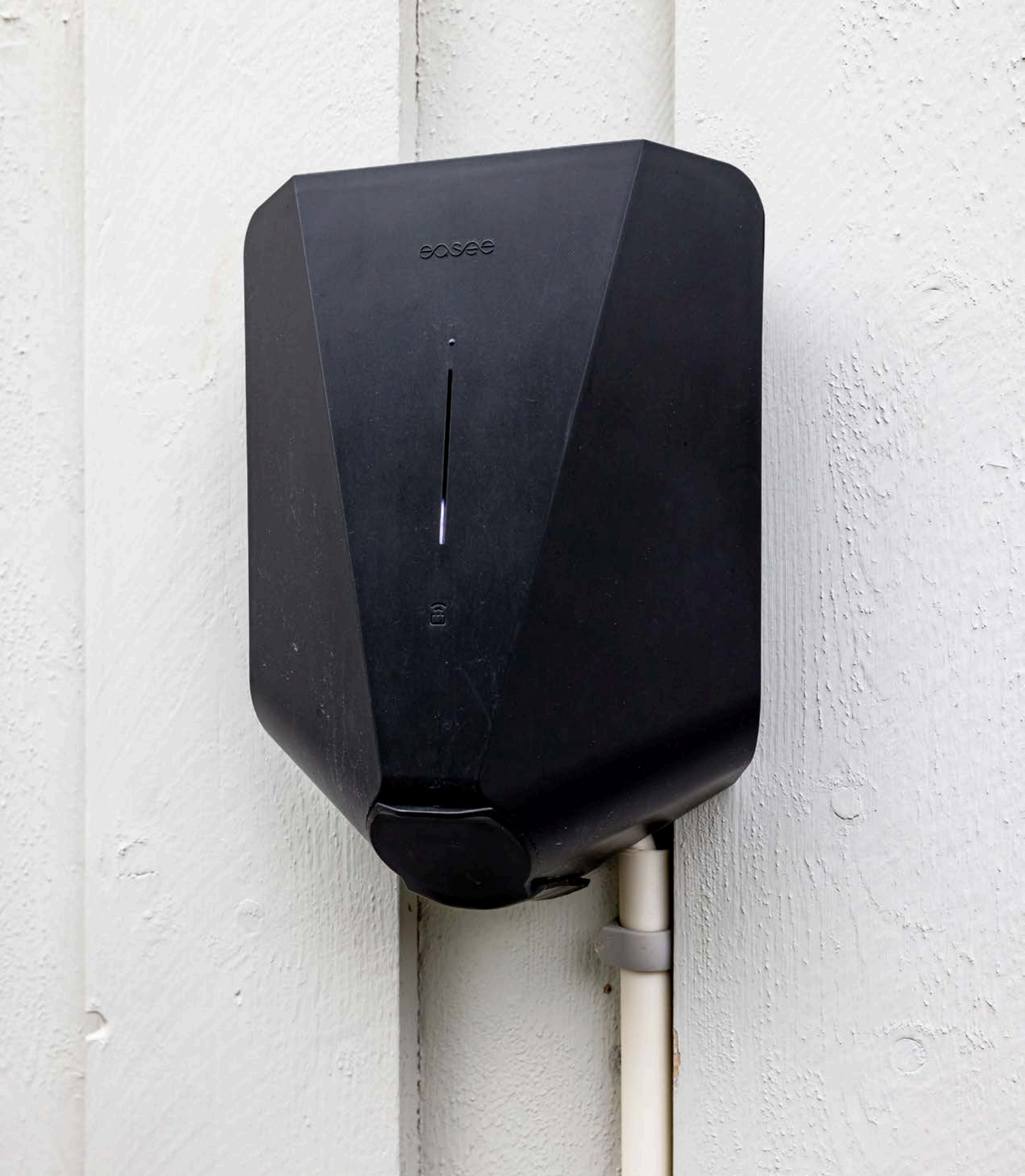
Det er montert elbil-lader på husveggen.
