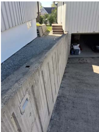
Det er ikke etablert rekkverk på støttemur.
