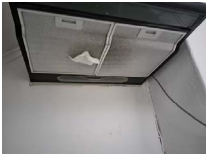
Avtrekkseffekten er testet med papir.
