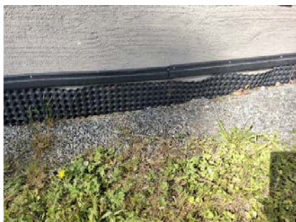
Grunnmursplast har løsnet fra topplist.
