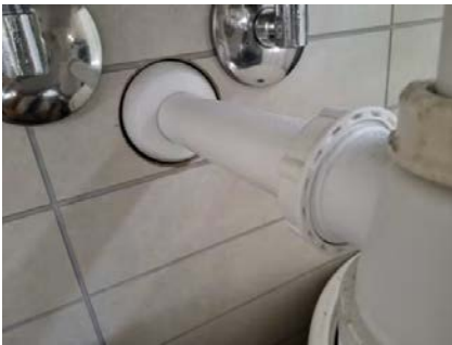
Utetthet rundt gjennomføring under servant.
