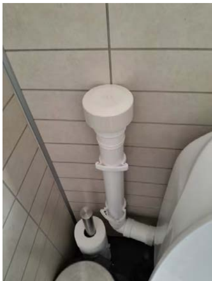
Vakuumventil er plassert på bad.
