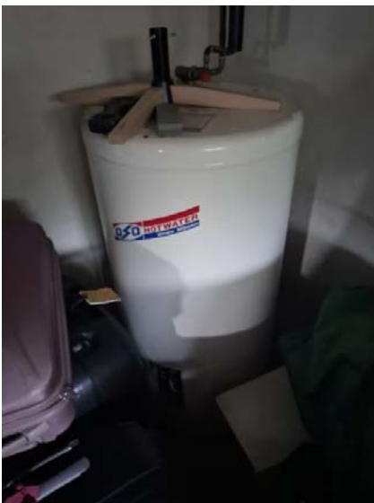
Varmtvannsbereder plassert i kjellerrom.
