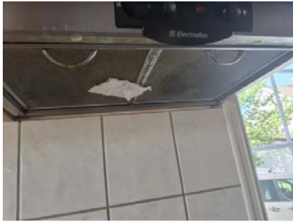
Avtrekkseffekten er testet med papir.
