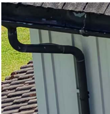
Det registreres buling på nedløpsrør.
