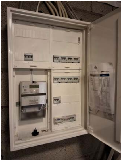
Sikringsskap i bod.
