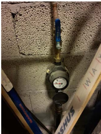
Hovedstoppekran er plassert i bod i kjeller.
