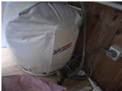
Varmtvannsbereder plassert i kjøkkeninnredning i loftsetasje.
