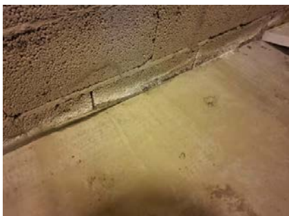
Det registreres salg/kalkutslag på grunnmur.
