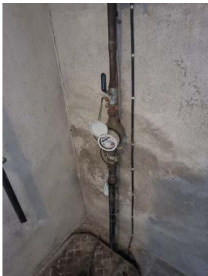
Hovedstoppekran er plassert i kjeller.
