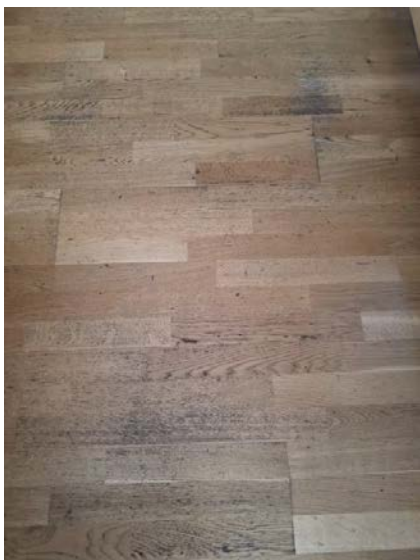
Kjøkkengulv bærer preg av slitasje.
