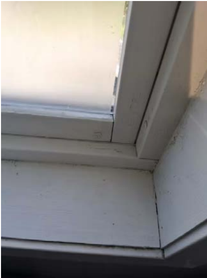
Tegn til kondens på registreres på enkelte vinduer.
