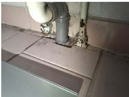
Utettheter og ingen synlig membran i gulv/vegg rundt rørgjennomføringer.
