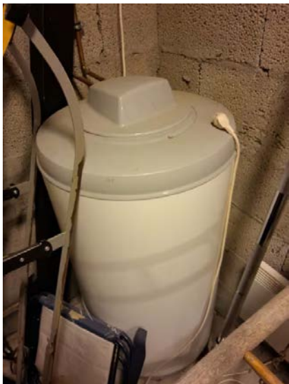
Varmtvannsbereder er plassert i bod.
