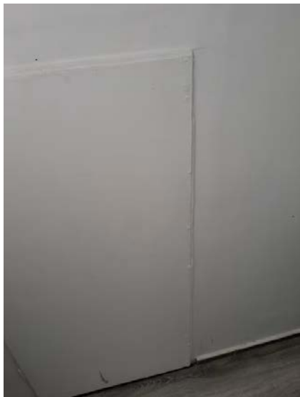
Luke til kott er gjenlimt med sparkel/maling.
