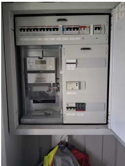
Sikringsskap plassert i gang.
