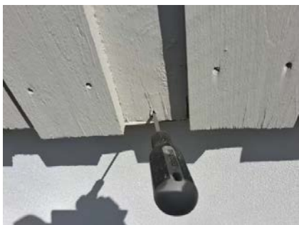
Stedvise råteskader i kledningen.
