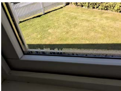
Det registreres kondens på soveromsvindu.
