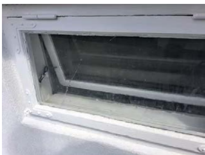
Sprekk i glass i kjellervindu.
