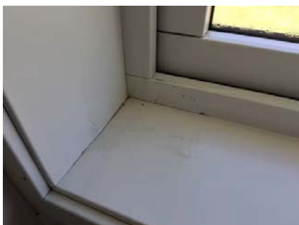
Svelleskader i utforing.
