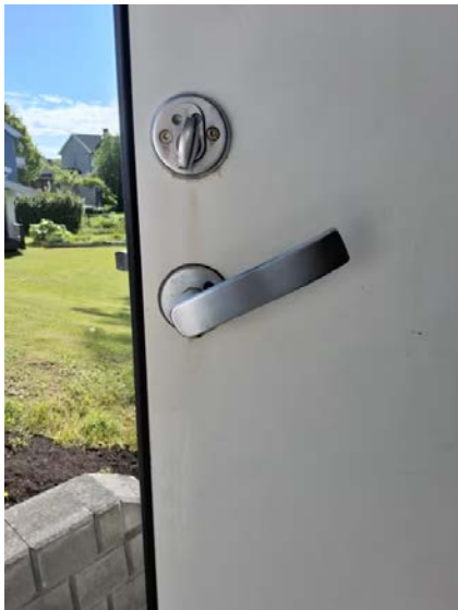
Defekt dørrider til entrédør.
