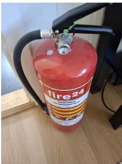
Brannslukningsapparat er ikke kontrollert de siste ti år.
