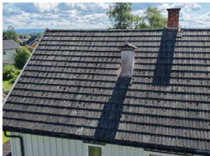
Det er ikke etablert snøfanger/takstige på taket.
