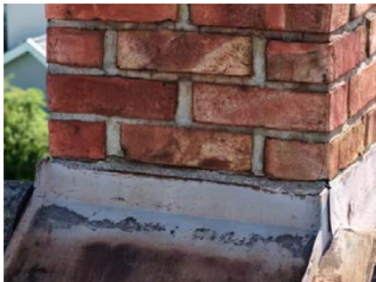
Det registreres riss i enkelte fuger på pipa.
