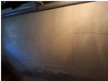
Riss/sprekker i grunnmuren.
