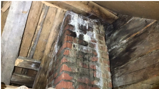
fukt/råteskader ved pipe
