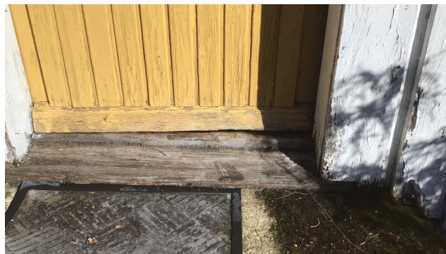
skader og slitasje i nedkant ytterdør
