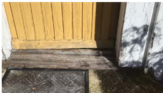
skader og slitasje i nedkant ytterdør
