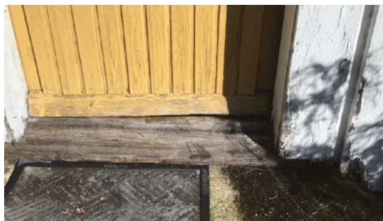
skader og slitasje i nedkant ytterdør
