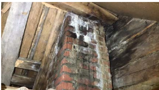
fukt/råteskader ved pipe
