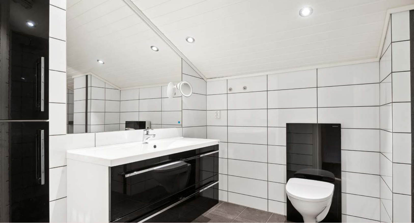
Pent bad på loftet oppgradert 2015. Arbeid utført av Grong Elektro, Namsskogan Rør og Namsskogan Bygg.
