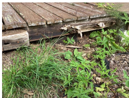
Råteskade på gulvkonstruksjon.
