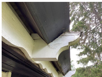
Det er oppsprekking i flere konsoller.
