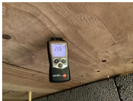
Høyt fuktinnhold i treverk.
