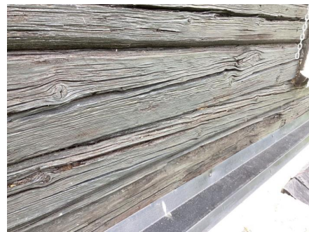
Eksempel på oppsprekking i tømmer.
