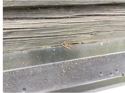
Eksempel på liten råteskade.
