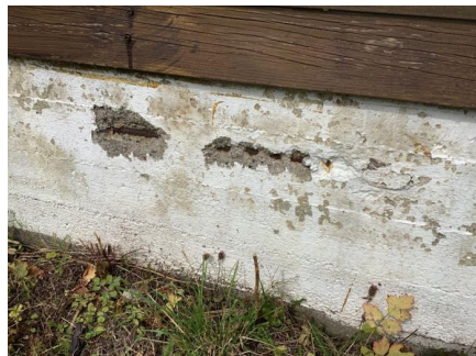
Avskaling på grunnmur.
