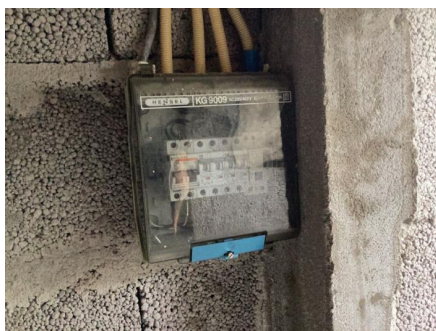
Sikringsboks i kjellerrom.
