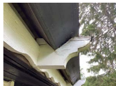
Det er oppsprekking i flere konsoller.
