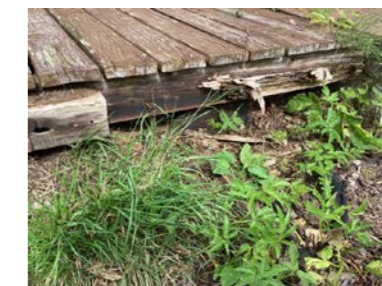
Råteskade på gulvkonstruksjon.
