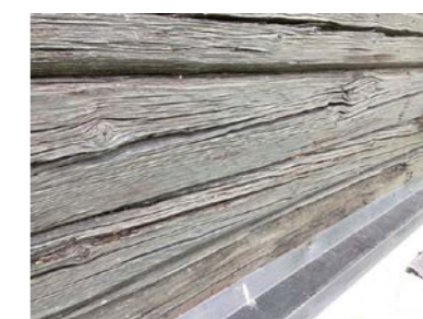
Eksempel på oppsprekking i tømmer.
