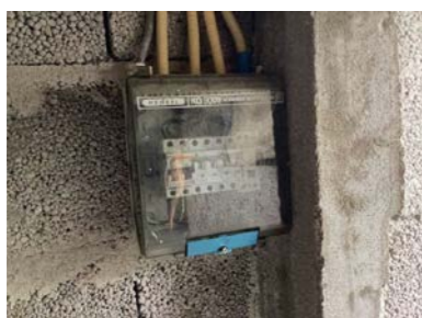
Sikringsboks i kjellerrom.
