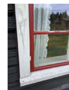
Eksempel på slitasje på omramming.
