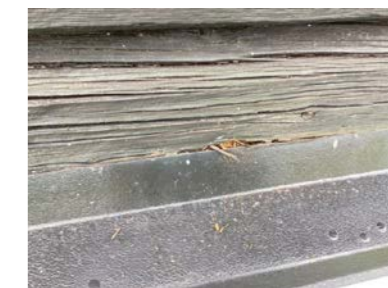
Eksempel på liten råteskade.
