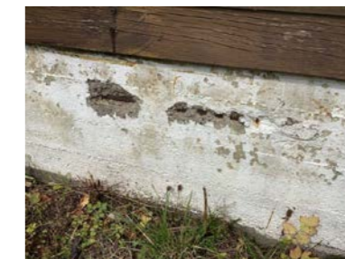
Avskaling på grunnmur.
