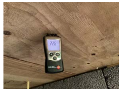
Høyt fuktinnhold i treverk.
