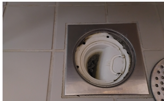
Sluk på gulvet.
