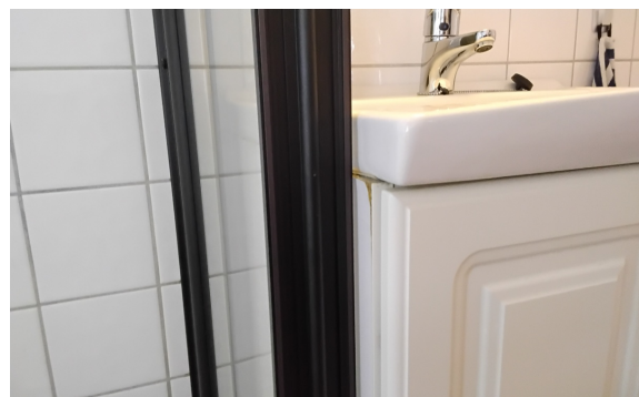
Fukt og svelle skade på innredning.
