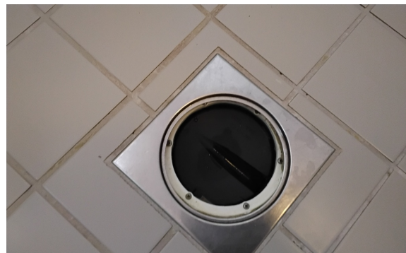
Sluk i dusjsonen
