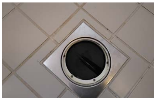
Sluk i dusjsonen
