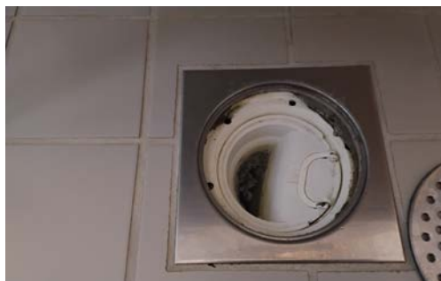
Sluk på gulvet.
