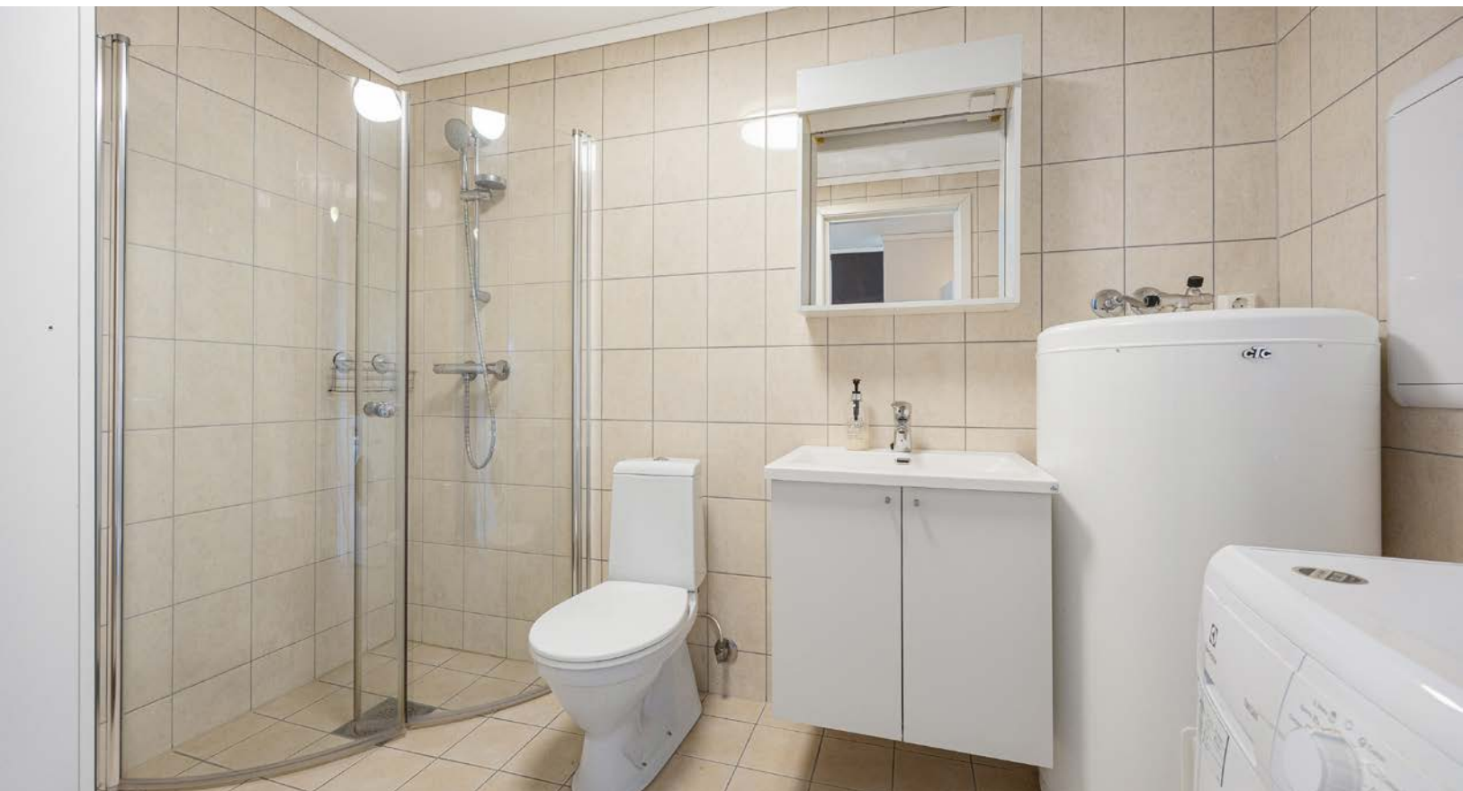
Det er opplegg for vaskemaskin på badet.
