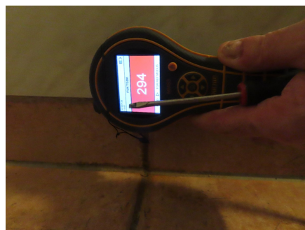
Påvist svært forhøyede fuktverdier i nedkant av baderomsplater inne i dusjnisen.
