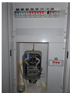
- Utleieleilighet: Sikringsskap i gang inne i leiligheten. Utermåler for intern avlesning av strømforbruk. Jordfeilautoamater fra renoveringsår.
