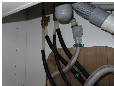
Det mangler endetetninger på kaldt og varmtvannsrør i kjøkkenbenk.
