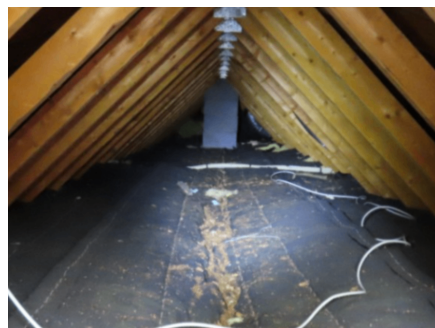
Pipe ses oppe på kaldloftet. Upussede overflater.
