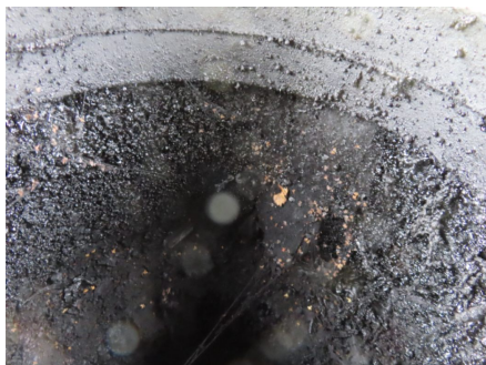
Pipe over tak. Det ses å mangle innerforing de siste 20 cm.
