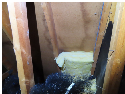
vannmerker i undertak.
