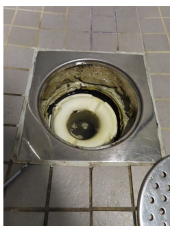
Plastsluk med klemring. Mansjett og membran påvist i sluk.
