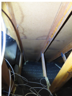
Vannmerker i undertakstekkingen/sutaksplatene.
