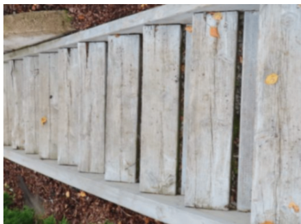
Merk slitasje i terrengtrappen.
