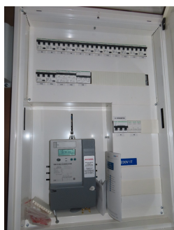
- Hovedleilighet: El-anlegg fra renoveringsår. Sikringsskap i gang med jordfeilautomater.
