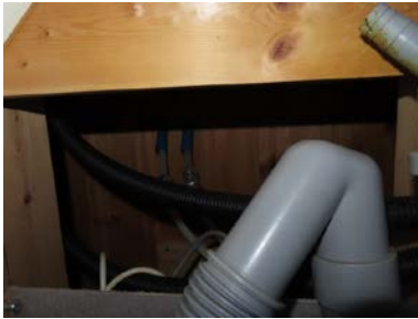
Det mangler endetetninger på kaldt og varmtvannsrør i kjøkkenbenk.
