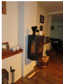
Peisovn som veggmontert i stue i utleieleiligheten. Sotluke under peisen - merk noe kort avstand til gulv fra sotluke.
