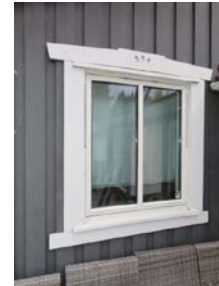
Merk at utvendige omramminger rundt vinduer er enklere montert direkte utenpå kledningen. Dette kan medføre at regnvann vil kunne renne ned mellom kledningen og omrammingslistene.
