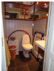
Toalettrom med gulvmontert toalett og vegghengt porselensservant.
