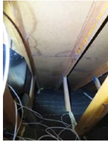
Vannmerker i undertakstekkingen/sutaksplatene.
