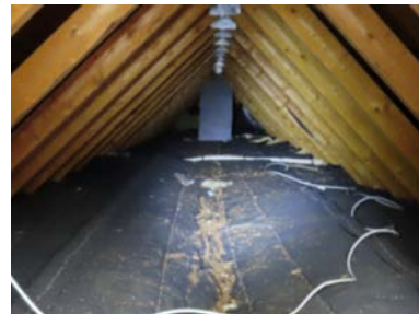
Pipe ses oppe på kaldloftet. Upussede overflater.
