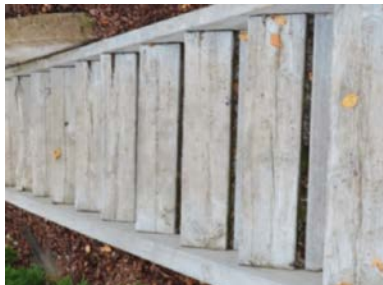
Merk slitasje i terrengtrappen.
