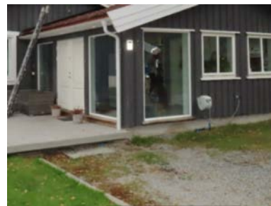
Ikke montert sålebensbeslag på fastkarmsvinduer i tilbygd del.
