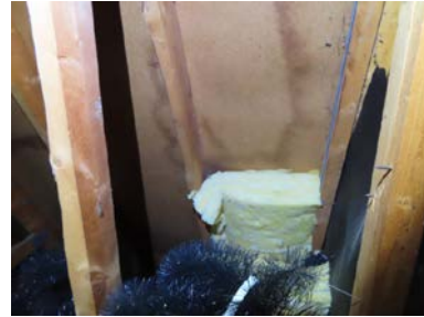
vannmerker i undertak.
