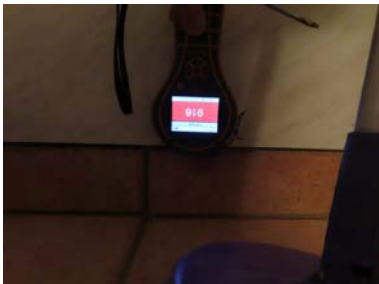
Påvist svært forhøyede fuktverdier i nedkant av baderomspålater inne i dusjnisen.
