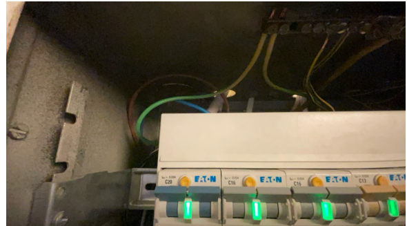
Det mangler tilfredsstillende tetting rundt kablene i sikringsskapet.
