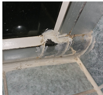
Silikon i tilknytning til dusjhjørne. Se også bilde under "overflater vegger og himling".
