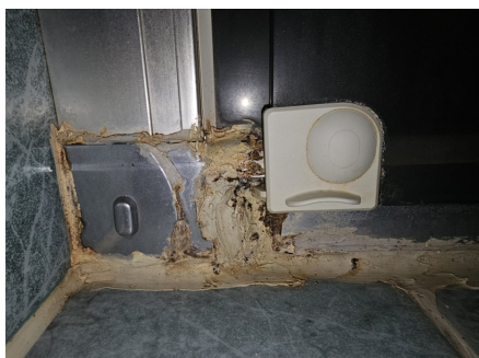
Svertesopp ved innfesting til dusjhjørne
