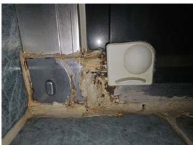
Svertesopp ved innfesting til dusjhjørne
