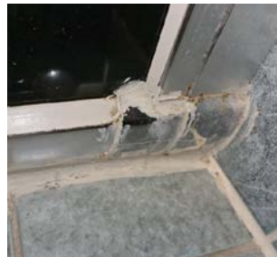
Silikon i tilknytning til dusjhjørne. Se også bilde under "overflater vegger og himling".
