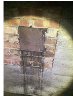
Det er noen rennemerker under sotluke.
