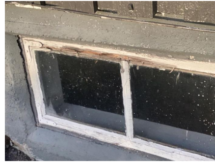
Råteskade på kjellervindu.
