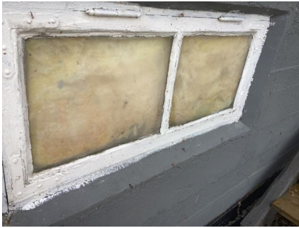
Eksempel på slitasje.
