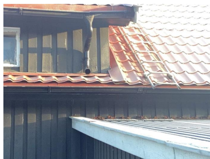
Stedvis enkel utførelse av beslagsarbeid.
