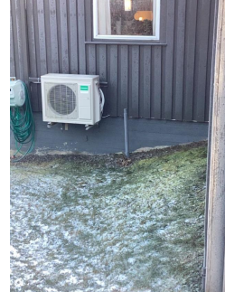
Utvendig stoppekran er defekt.
