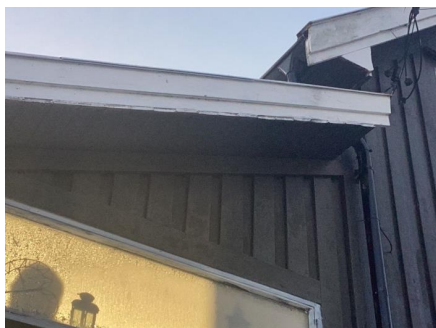
Det er stedvis utradisjonelle avslutninger på konstruksjoner.
