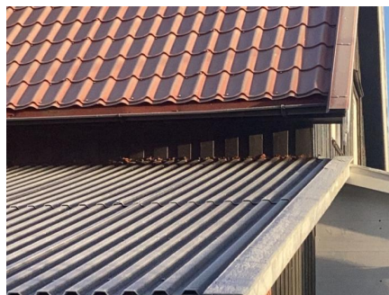
Det er utett overgang mellom takking over veranda og vegg.
