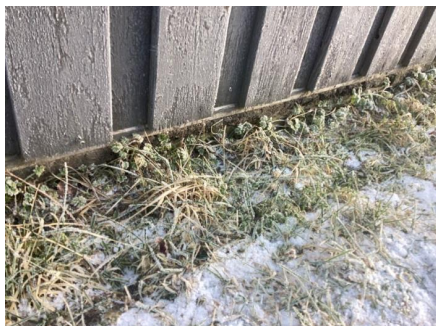
Gulvkonstruksjon på veranda ligger delvis under bakken og det er observert begynnende råteskader.
