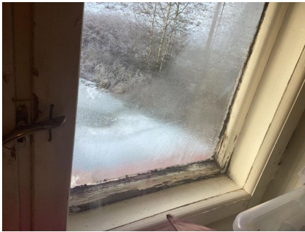
Fuktskader på vindu i takløft i 2. etasje.
