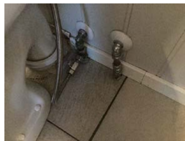
Ukjent utførelse av tetting rundt gjennomføringer.
