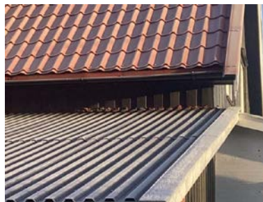
Det er utett overgang mellom takking over veranda og vegg.
