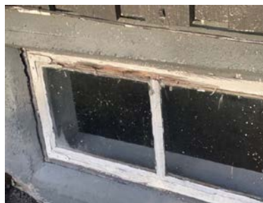
Råteskade på kjellervindu.
