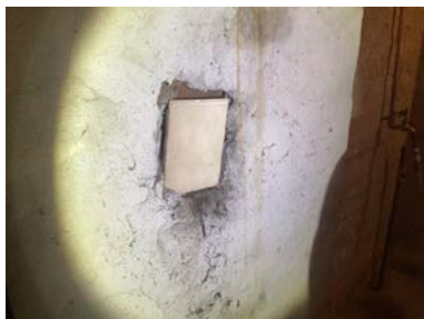
Tidligere utsparing for ovn i kjeller er tettet med plastlokk.
