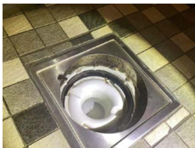
Det er synlig mansjett i tilslutning til sluk.
