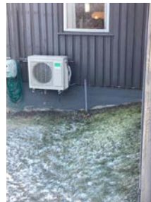
Utvendig stoppekran er defekt.
