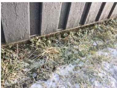
Gulvkonstruksjon på veranda ligger delvis under bakken og det er observert begynnende råteskader.
