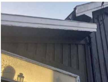
Det er stedvis utradisjonelle avslutninger på konstruksjoner.
