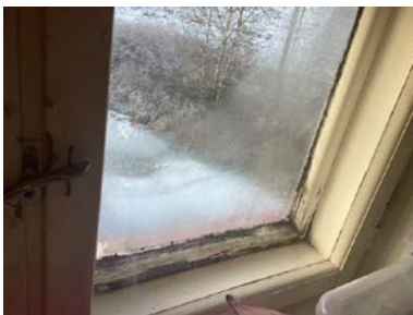
Fuktskader på vindu i takløft i 2. etasje.
