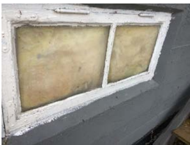
Eksempel på slitasje.
