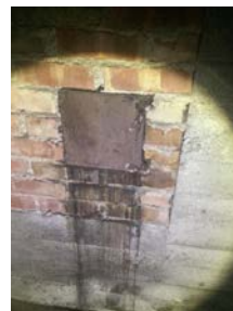
Det er noen rennemerker under sotluke.
