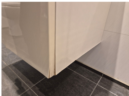
Fuktsveller på innredning.
