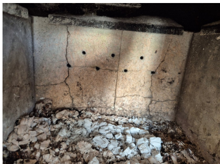
Sprekker i ildfast stein.
