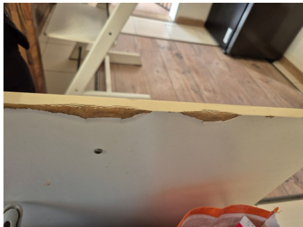
Fuktsveller på innredning.
