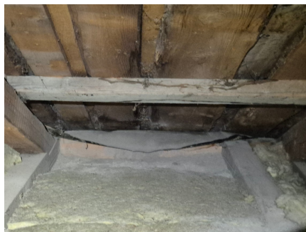
Lite luft i nedre del av konstruksjon.
