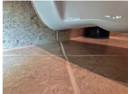
Ikke drenshull under toalett.
