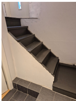
Mangler rekkverk på kjellertrapp.
