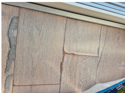
Skade på laminat ved terrassedør.
