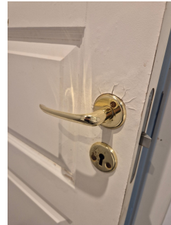
Fuktskader på badersdør i kjeller.
