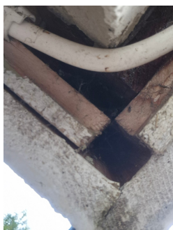
Mangler musesperre i hjørnekasse.
