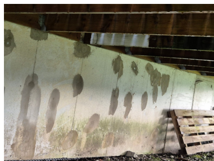
Ikke pusset under terrasse.
