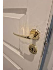
Fuktskader på baderomsdør i kjeller.
