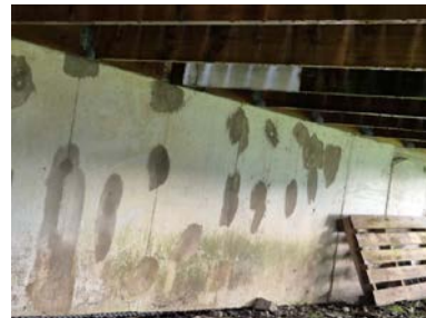
Ikke pusset under terrasse.
