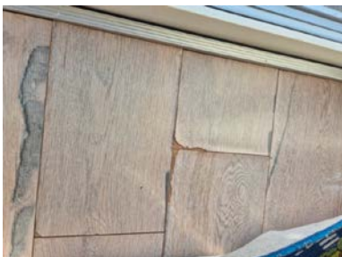
Skade på laminat ved terrassedør.
