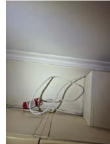
Løse ledninger og ufagmessig utførelse.
