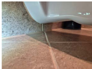
Ikke drenshull under toalett.
