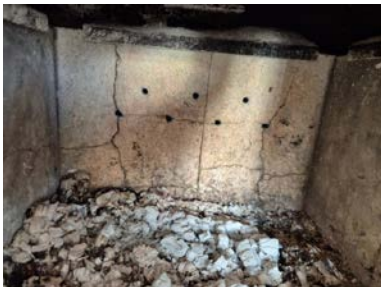
Sprekker i ildfast stein.
