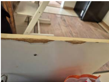
Fuktsveller på innredning.
