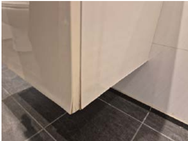
Fuktsveller på innredning.
