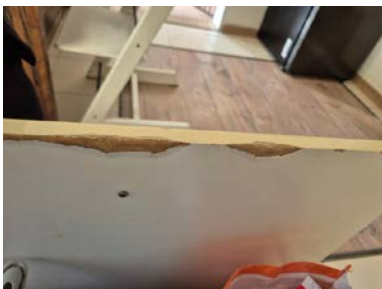
Fuktsveller på innredning.
