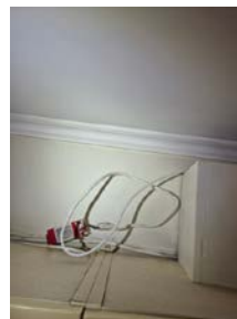
Løse ledninger og ufagmessig utførelse.
