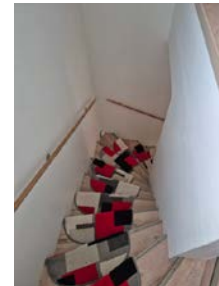
Mangler håndløper på en side og for lavt rekkverk.
