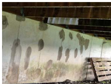
Ikke pusset under terrasse.
