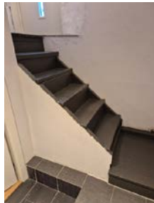
Mangler rekkverk på kjellertrapp.
