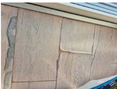
Skade på laminat ved terrassedør.
