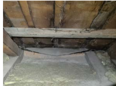
Lite luft i nedre del av konstruksjon.
