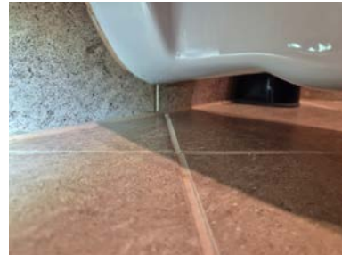
Ikke drenshull under toalett.
