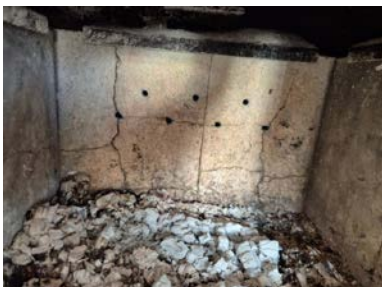
Sprekker i ildfast stein.
