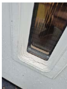
Værslitte glasslister til kjellerdør.
