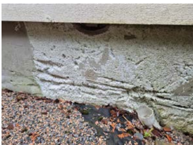
Ikke pusset utenfor inngangspartiet.
