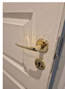
Fuktskader på baderomsdør i kjeller.
