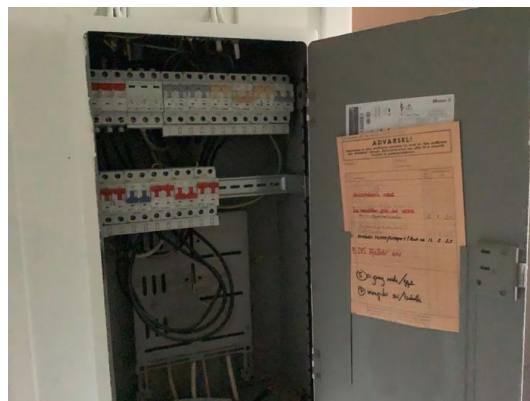
Sikringsskapet er plassert i gang i 2.
